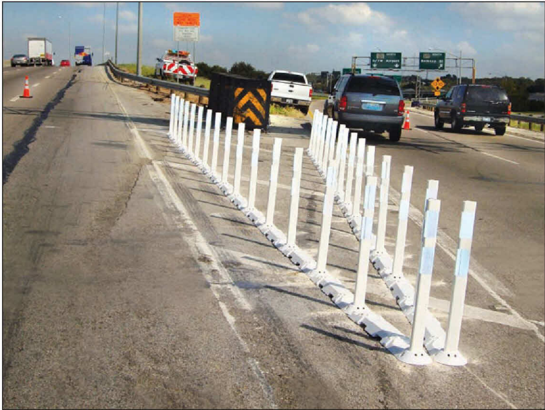
◀ Impact Attenuator Protection
